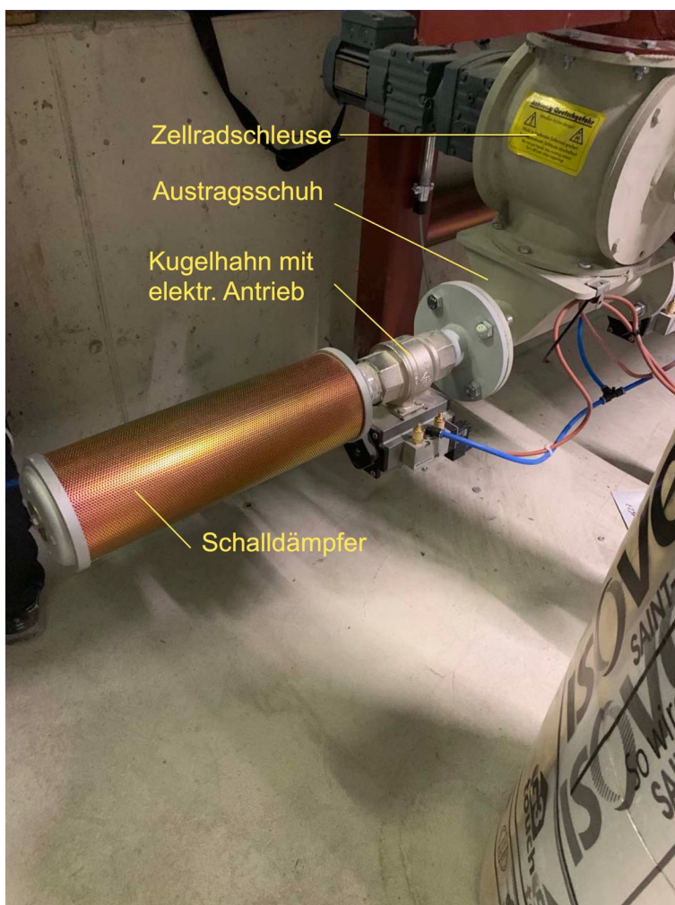
Abbildung 9: Staubaustrag und Staubabsaugung Filter OL II Krematorium Aarau
