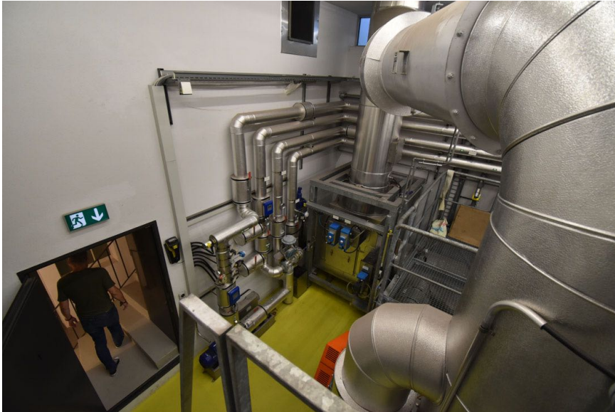
Abbildung 5: Rauchgasreinigungsanlage im Filterraum. Zugangstür zum Filterraum vom Ofenraum Sockelgeschoss
