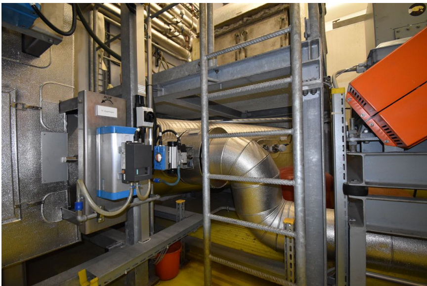
Abbildung 6: Rauchgasreinigungsanlage im Filterraum mit Rauchgaskanal, Eintrittsklappe K1, Wartungsbühne Wärmetauscher und Rückführleitung für Anfahraufheizung
