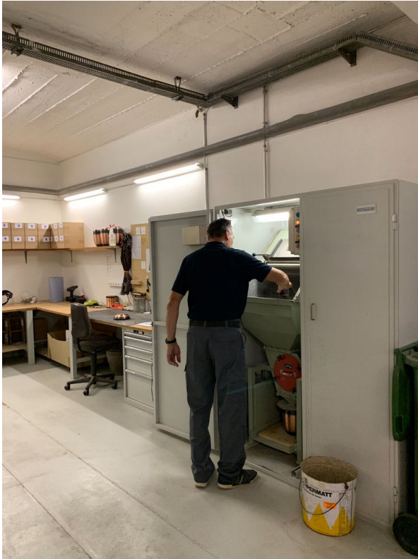
Abbildung 7: Aschemühle mit Staubabsaugung im rechten Schrankfeld
