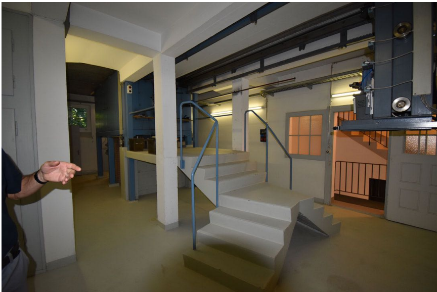
Abbildung 3: Ofenraum Sockelgeschoss mit Podest Ascheentnahme
