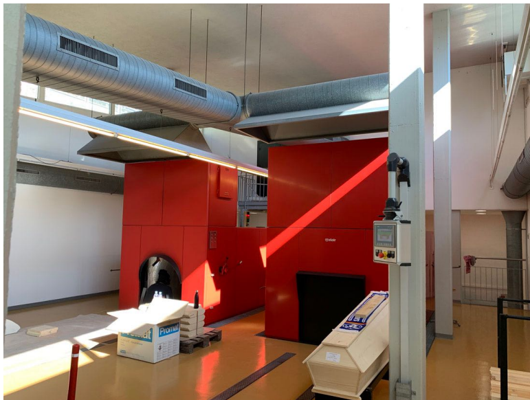
Abbildung 13: Touch Panel neuer Elektroofen (rechts) Krematorium Schwyz
