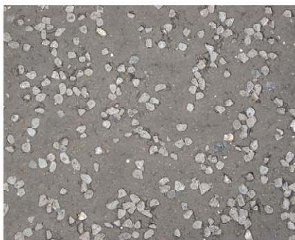
Asphalt mit hellen Einsprenglingen
